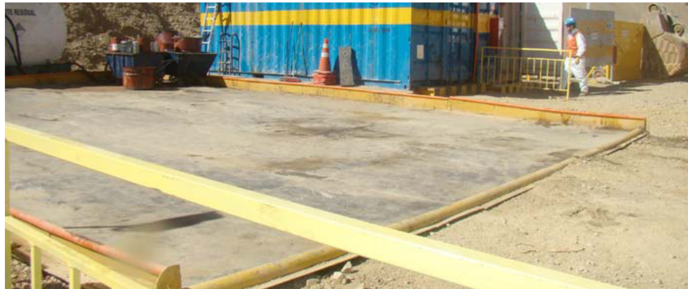
Superficie tipo para equipos en mantención, impermeable y con pretil de contención de derrámes.
