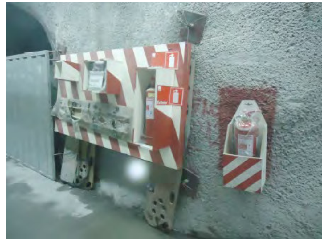
Figura 17.- Extintores en la caja del túnel.
