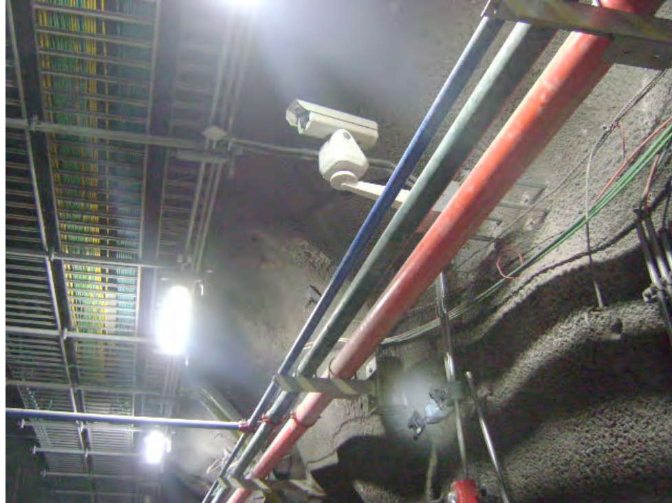
Figura 20.- Cámara de CCTV del tipo PTZ en la zona de obras.
