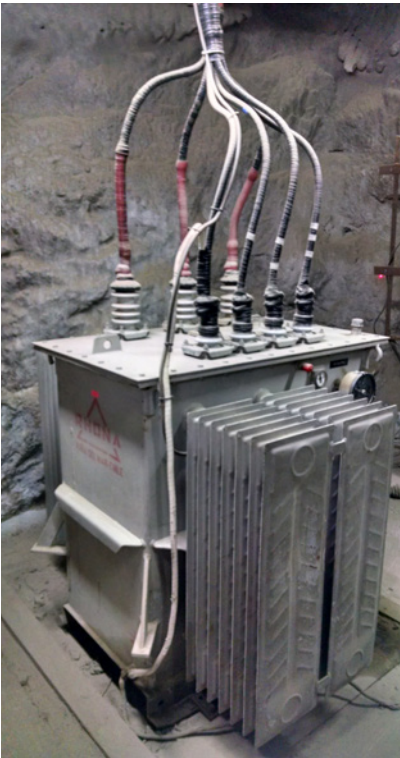
Figura 9.1: Transformador con bornes a la vista
