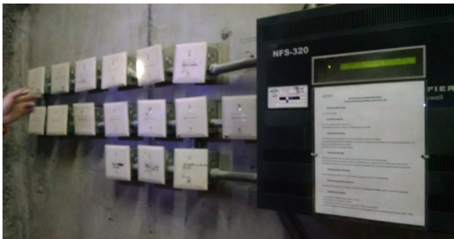
Figura 8.8: DPanel de control y alarma de incendio.
