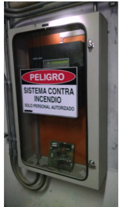
Figura 8.1 Panel de control de extinción.
